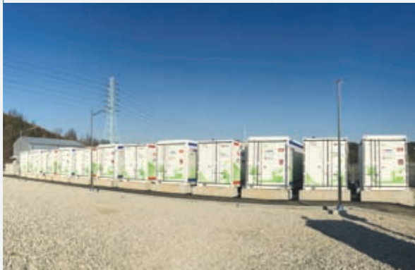
한국전력공사 신계동 변전소 PCS : 24MW / 배터리 : 6MWh 주파수 조정용
