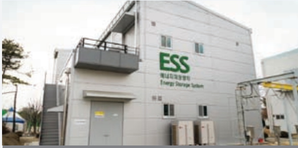
중랑 물재생센터 (서울) PCS : 3MW / 배터리 : 18MWh 부하 이동용
