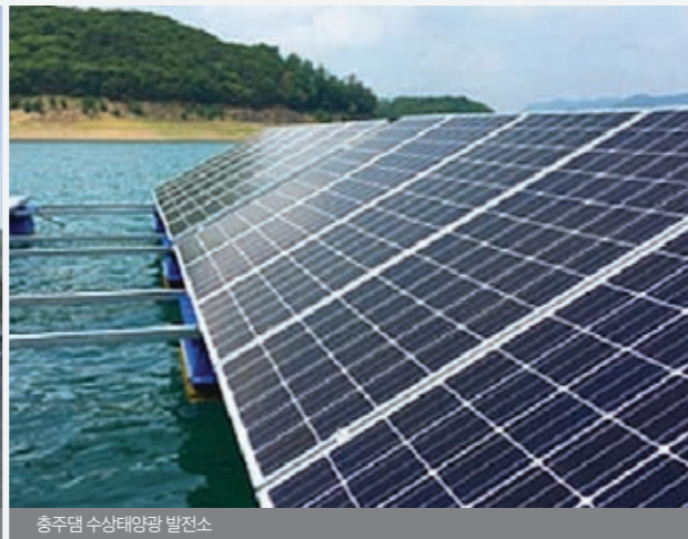
충주댐 수상태양광 발전소
