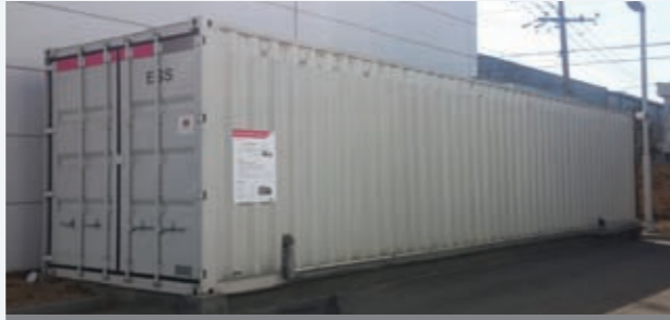
LG 전자(인천) PCS : 4MW / 배터리 : 1MWh 주파수 조정용
